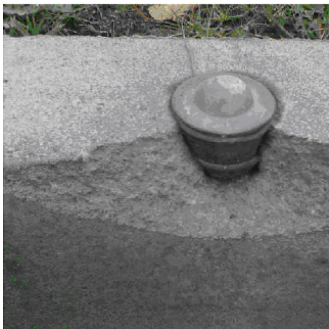
Obrázek 9 Nesprávné umístění (příliš na okraji obrubníku)
